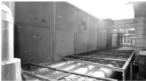
图2 屋面平台多功能风冷热泵机组放置
